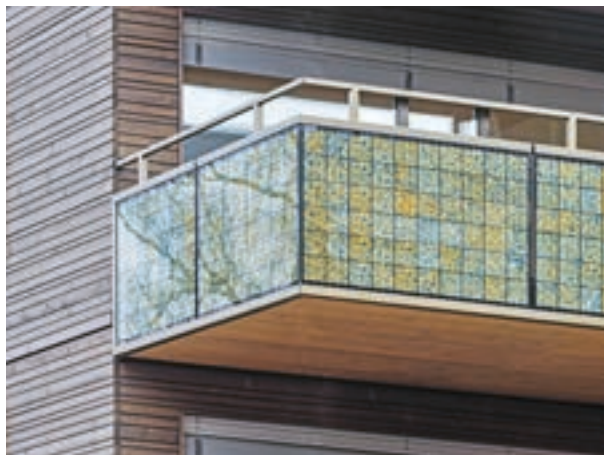
PARAPETTI DI BALCONE CON MODULI FV POLICRISTALLINI PER UNA CASA PLURIFAMILIARE NELLA ZWYSSIGSTRASSE, ZURIGO
