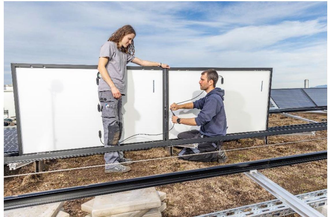
Cablaggio dei moduli
